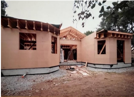
Figure 24 : Photographies avant-projet de la construction de la Maison Bois, Terre, Paille. Source : Laurant A.
