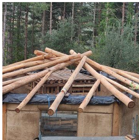
Figure 29 : Photographie des travaux de construction du toit du Flexagone à une étape supérieure.
